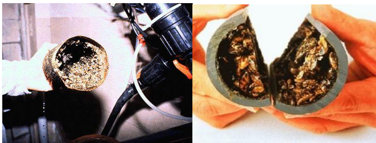
Рисунок 1.3 – Слой дрейссены на внутренних стенках трубопроводов
