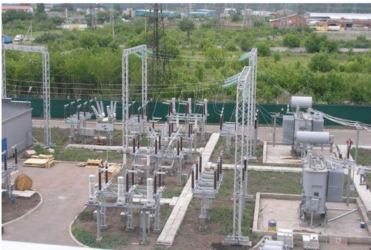
Рисунок 1.1 – Подстанция 35/10 кВ «Северная»
