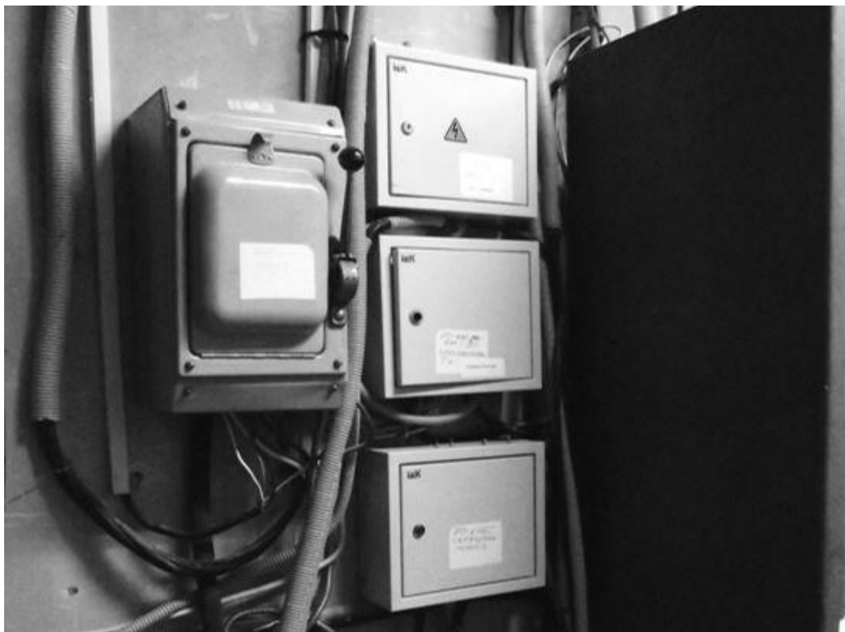
Рисунок 3.5 – Ящики силовые с рубильниками для отдельных помещений
