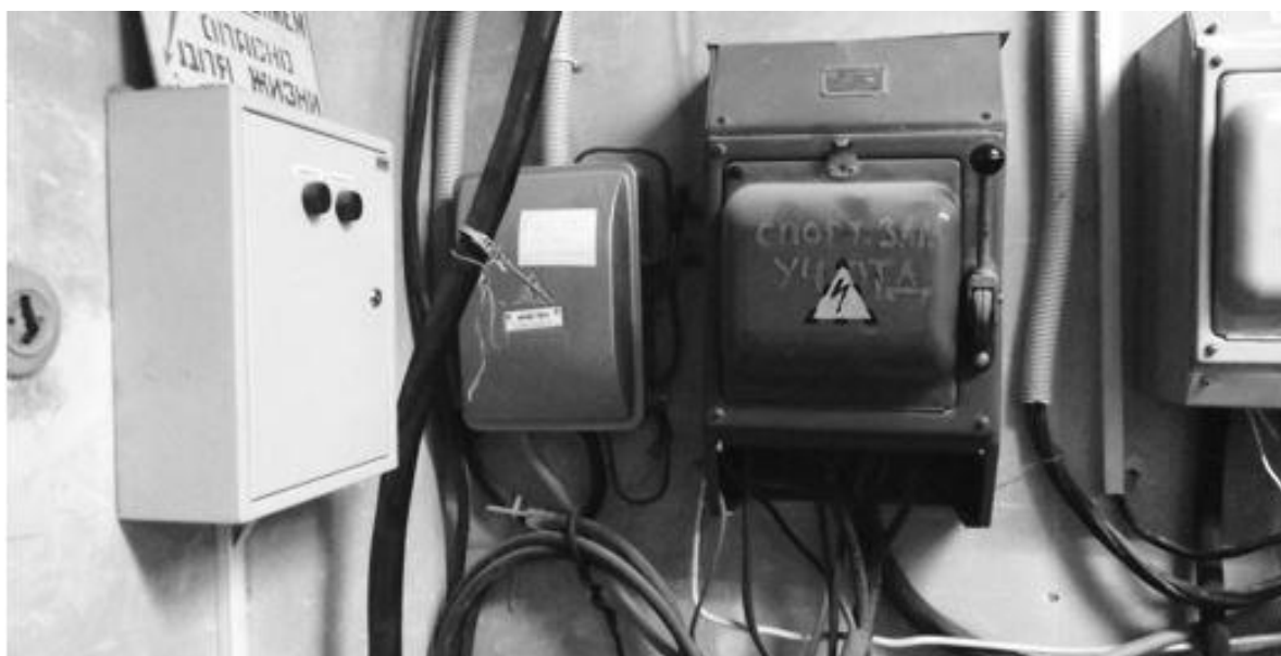
Рисунок 3.4 – Ящики силовые с рубильниками для отдельных помещений
