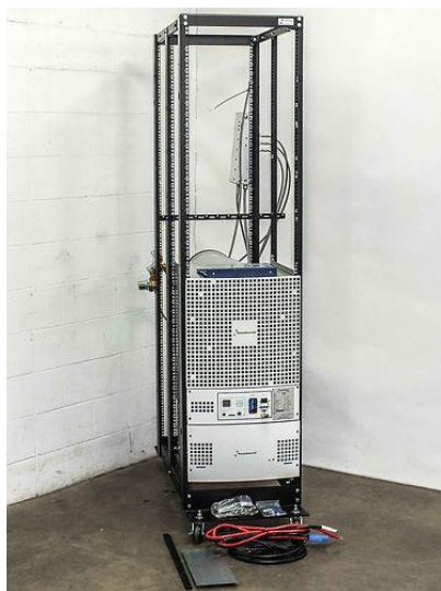
Рисунок 33 – DBX 5000 установленный в стойке, в закрытом помещении
