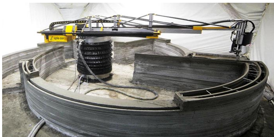
Рисунок 2 – Процесс изготовления здания при помощи 3D принтера Также активно разрабатывается и внедряется в военной сфере (Рисунок 3).
