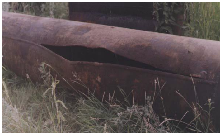
Рисунок 1.8 – Разрушение прямошовной электросварной трубы
