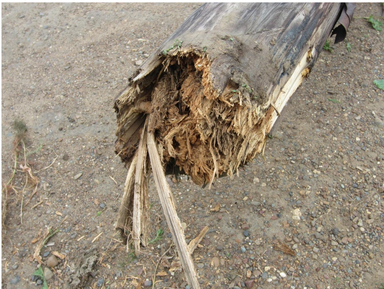
Рисунок 9 – Деревянная опора гнилая изнутри
