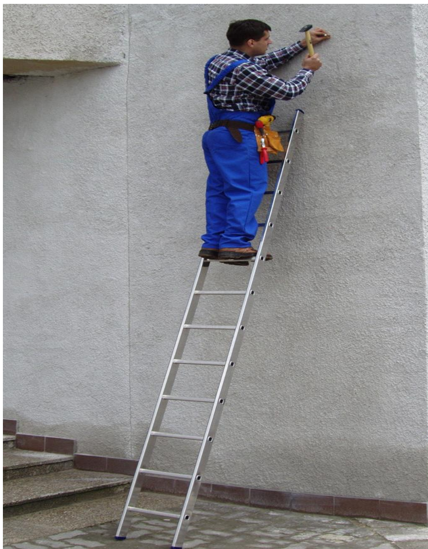
Рисунок 6 – Неправильная работа с применением приставной лестницы
