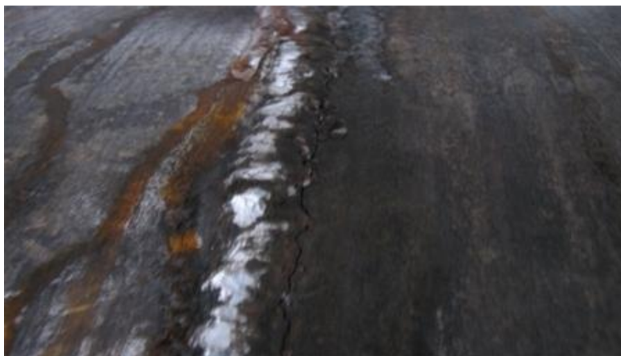
Рисунок 1.3 - Трещина вдоль зоны расплава корпуса насоса после ремонта
