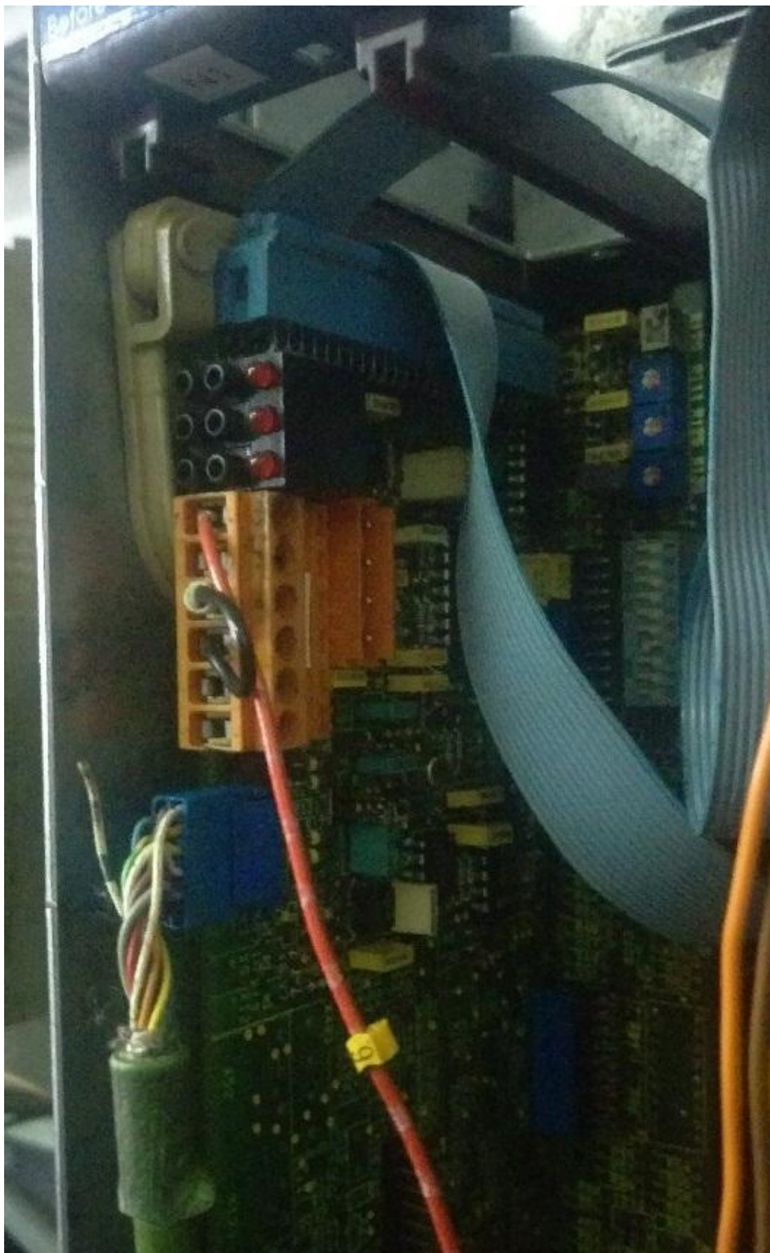
Рисунок 1.16 – Плата управления комплектного электропривода
