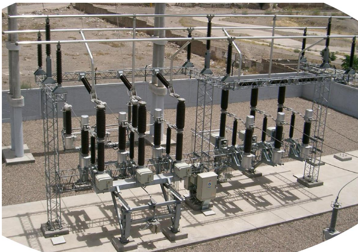
Рисунок 6.1 –ОРУ 110 кВ на элегазовом оборудовании
