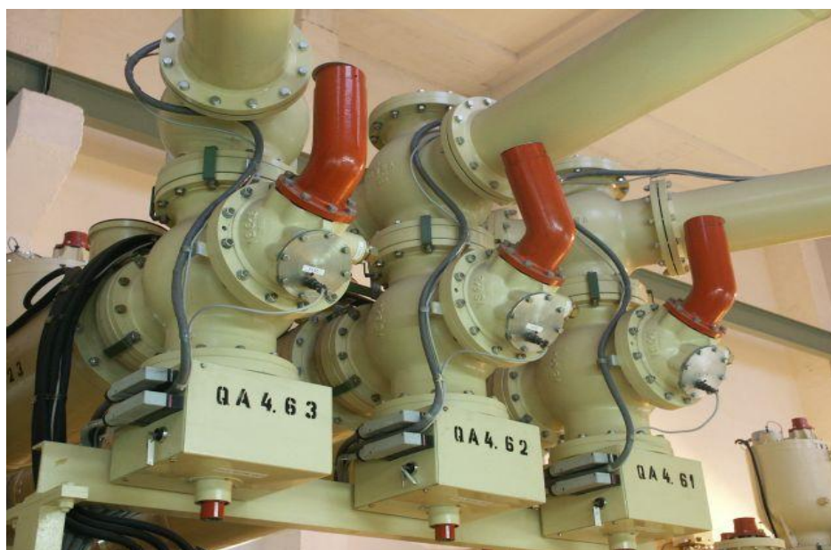
Рисунок 1.4 – Распределительные устройства с элегазовой изоляцией
