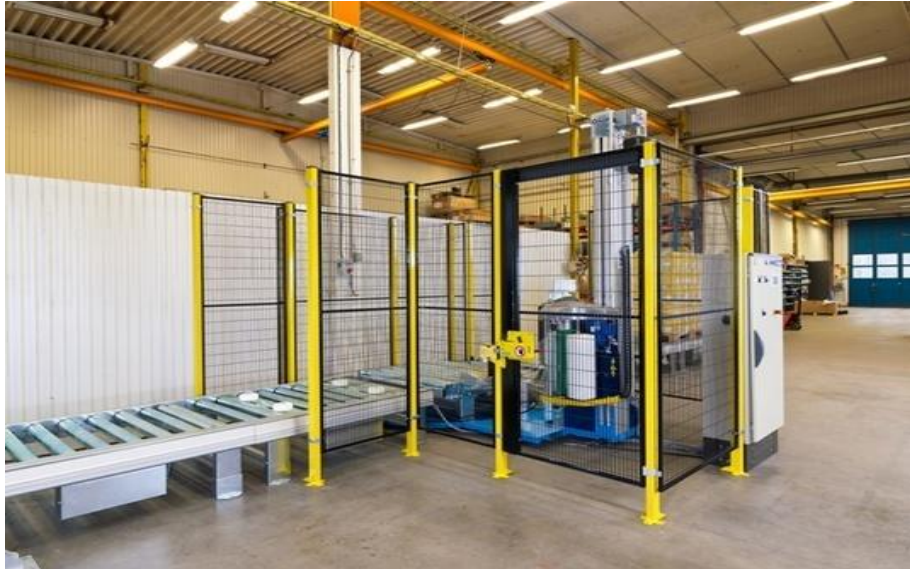
Рисунок 3.2 – Ограждение у оборудования
