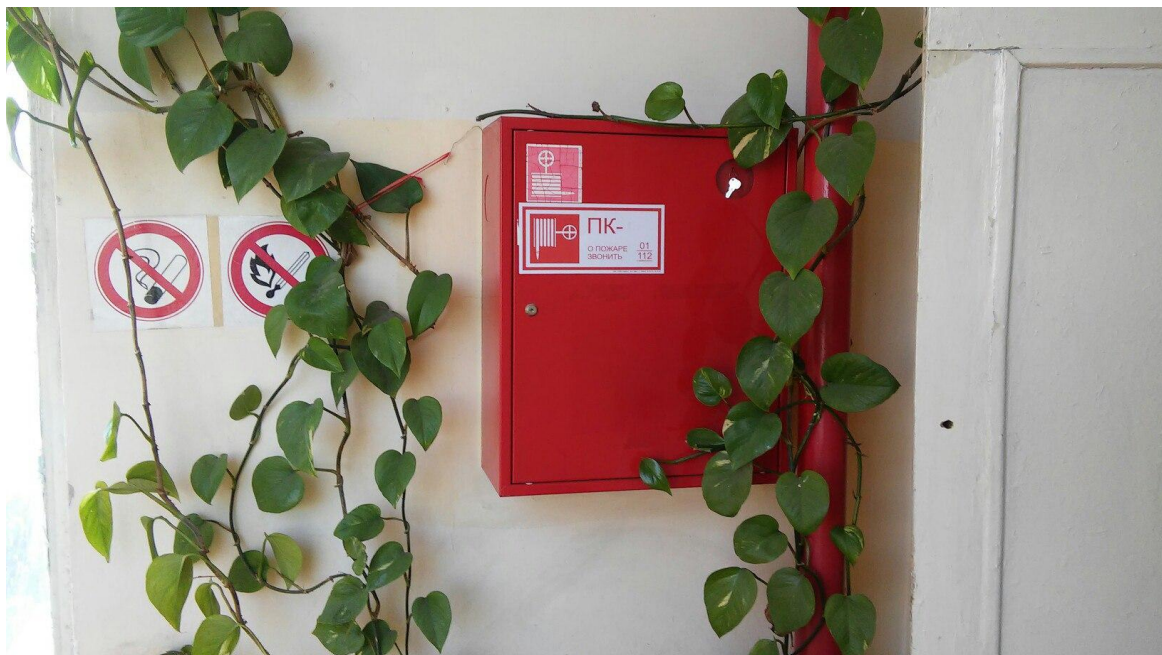
Рисунок 3 – Пожарный кран в МП «ТПАПТ №3»
