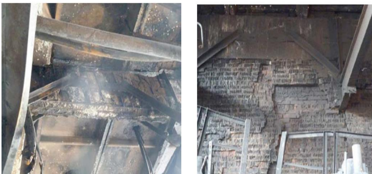
Рисунок 3.3 - Вид на первый ярус сооружений, подверженных длительному воздействию огня
