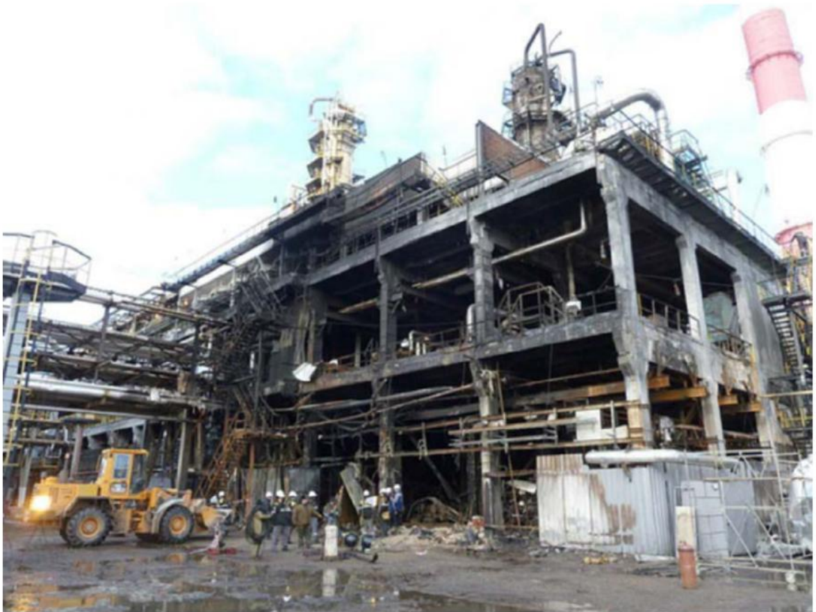
Рисунок 3.1 - Общий вид сооружения после огневого воздействия
