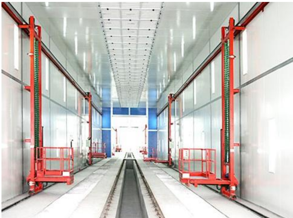
Рисунок 4.1 - Общий вид окрасочной камеры с лифт-площадками
