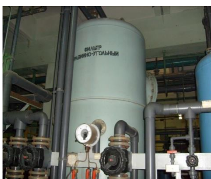
Рисунок 5.1 – Очистное сооружение производственной канализации
