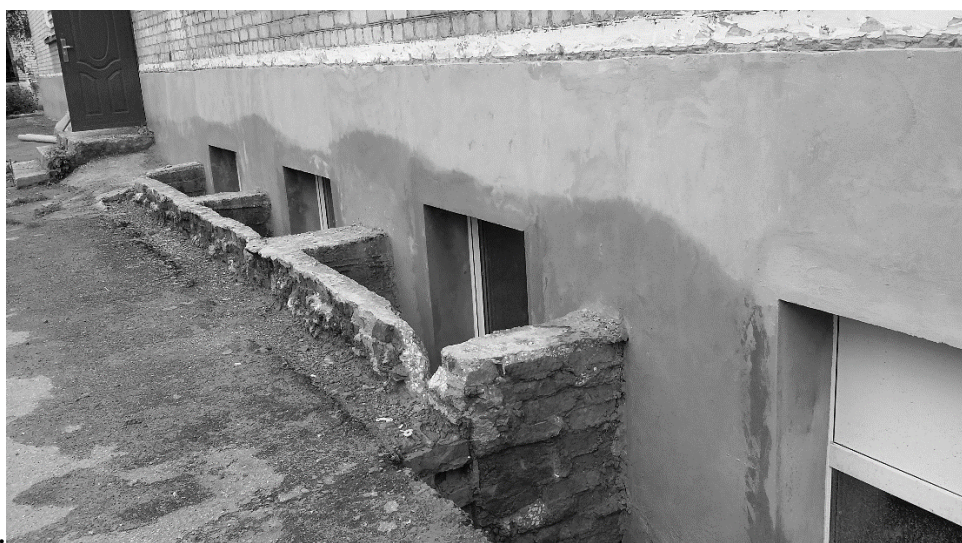
Рисунок 17 – Фото, отображающее разрушение приямка со стороны улицы Комзина
