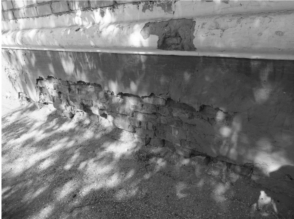
Рисунок 24 – Фото, отображающее разрушение поверхности кирпичных стен со стороны улицы Комзина
