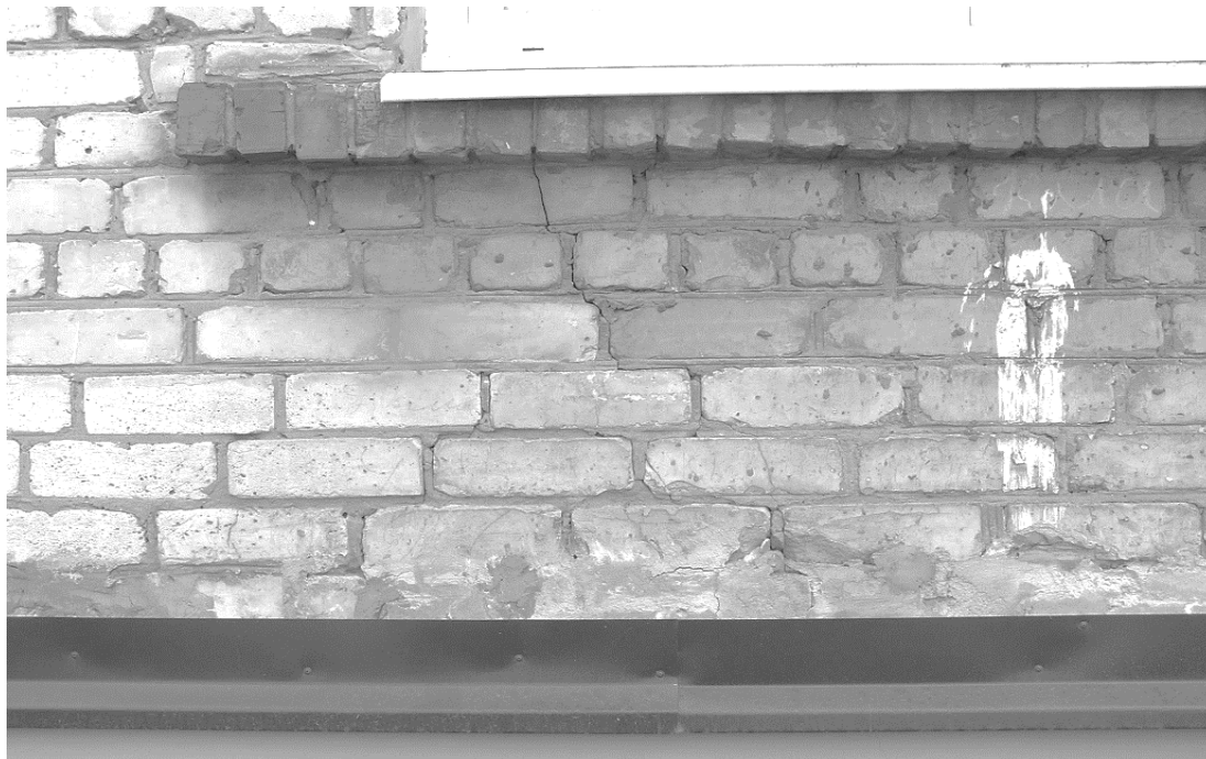
Рисунок 16 – Фото, отображающее разрушение стены со стороны улицы Комзина
