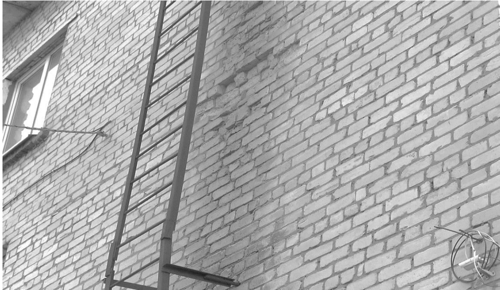
Рисунок 22 – Фото, отображающее разрушение поверхности стены, северный фасад
