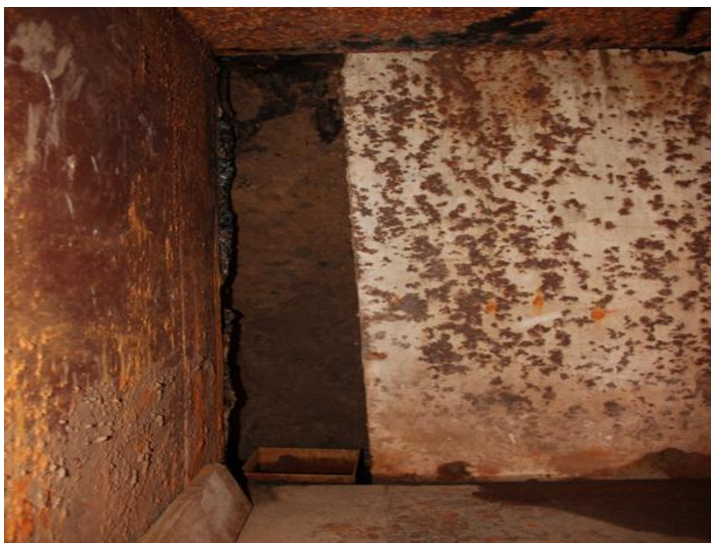
Рисунок 11 - а) Не использованный технологический проём (ось Г, в рядах 6-7); б) Технологический проём (ось Г, в рядах 6-7). На снимке видны: обратная засыпка, доска, окрашенный стальной лист.
