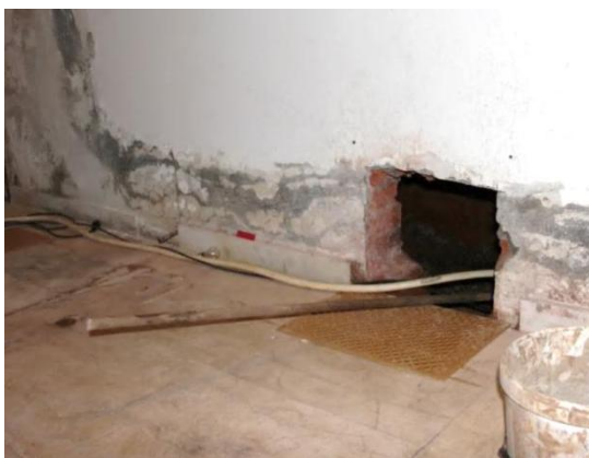
Рисунок 18 - Южное крыльцо. Лаз под Лм2. Установленный насос «Гном»
