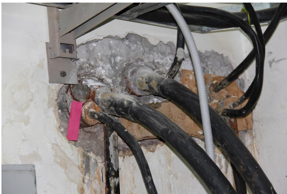
Рисунок 12 - Узел ввода кабелей в электрощитовую (ось К, в рядах 4-5).
