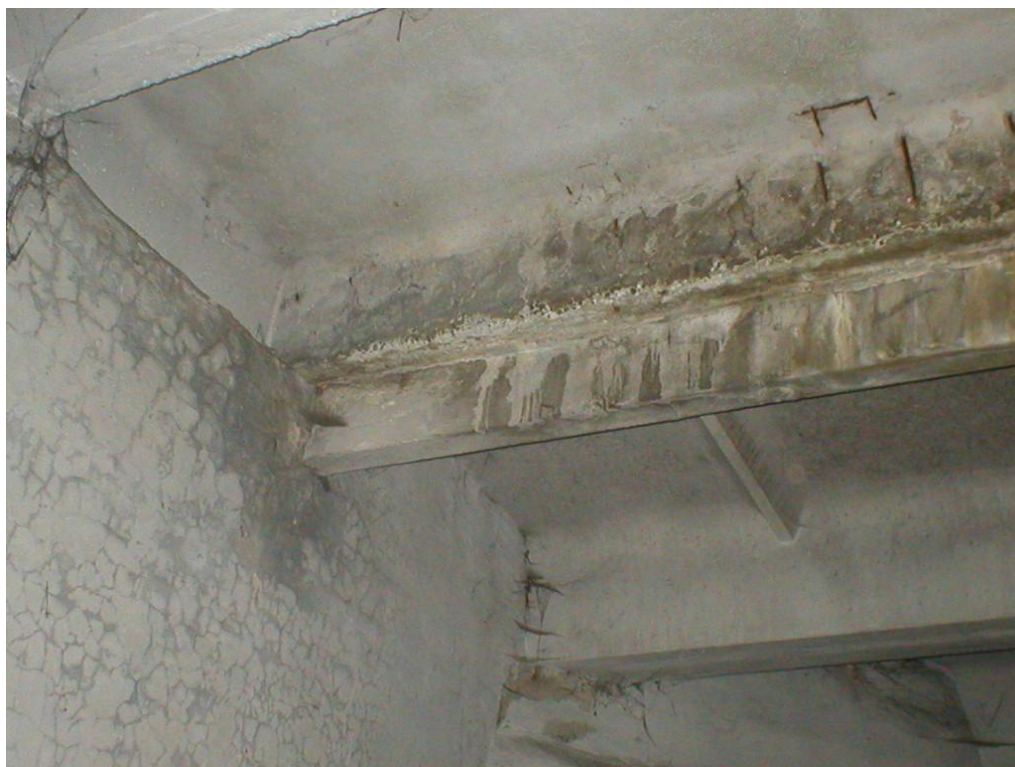
Рисунок – А.1 Состояние внутренней стены по оси «Н»
