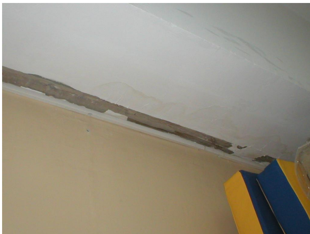
Рисунок – А.4 Замачивание стены подвала и перекрытия
