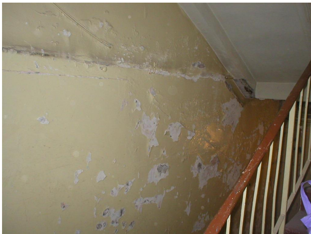
Рисунок— А.3 Состояние стены между подвалом и дебаркадером
