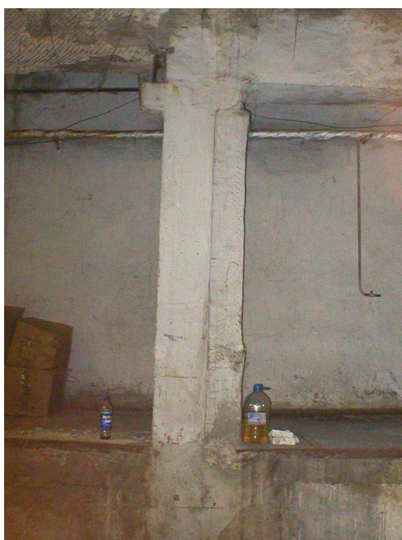
Рисунок – А. 6 Состояние стен подземного помещения
