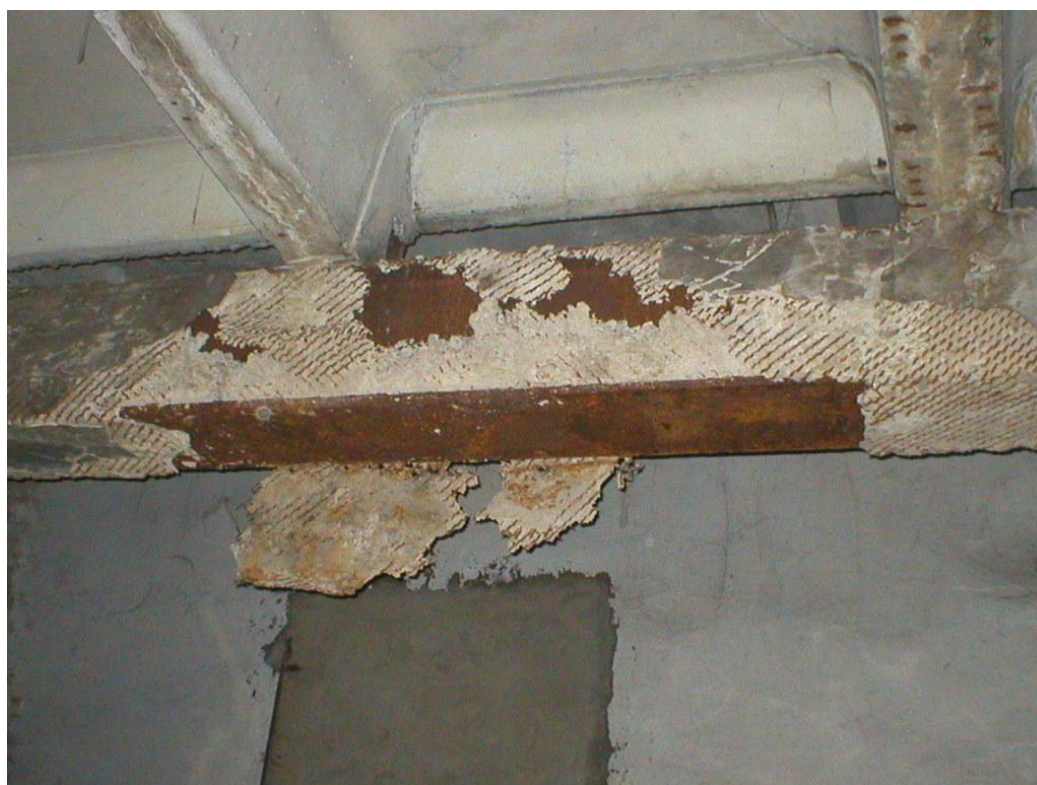
Рисунок – А. 8 Общее состояние металлической балки по оси «Л». Коррозия косвенной арматуры в ребрах плит
