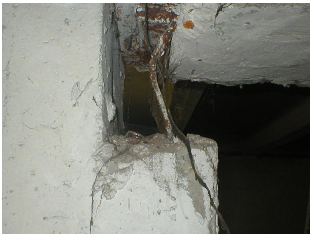
Рисунок – А.7 Опираие металлических балок на консоль колонны через дополнительные столики. Деформации стенок двутавровых подставок
