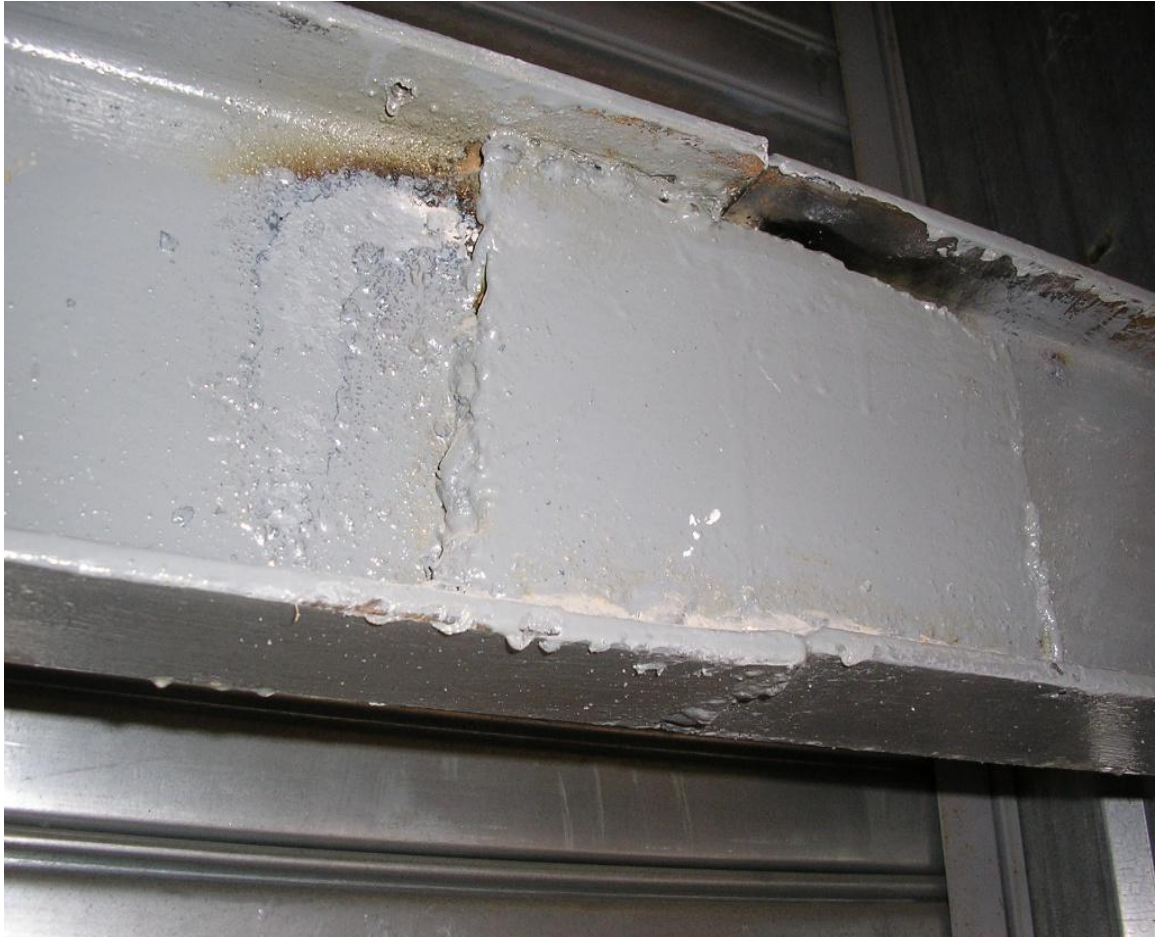
Рисунок 3 –Некачественно выполненный сварной стык стальных конструкций.
