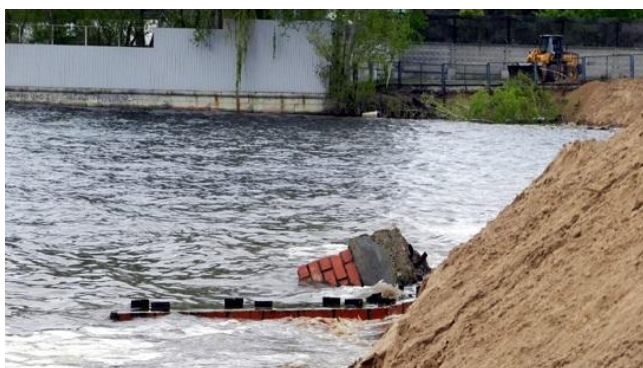
Рисунок 3.3 – Разрушения береговой линии в районе Итальянского пляжа
