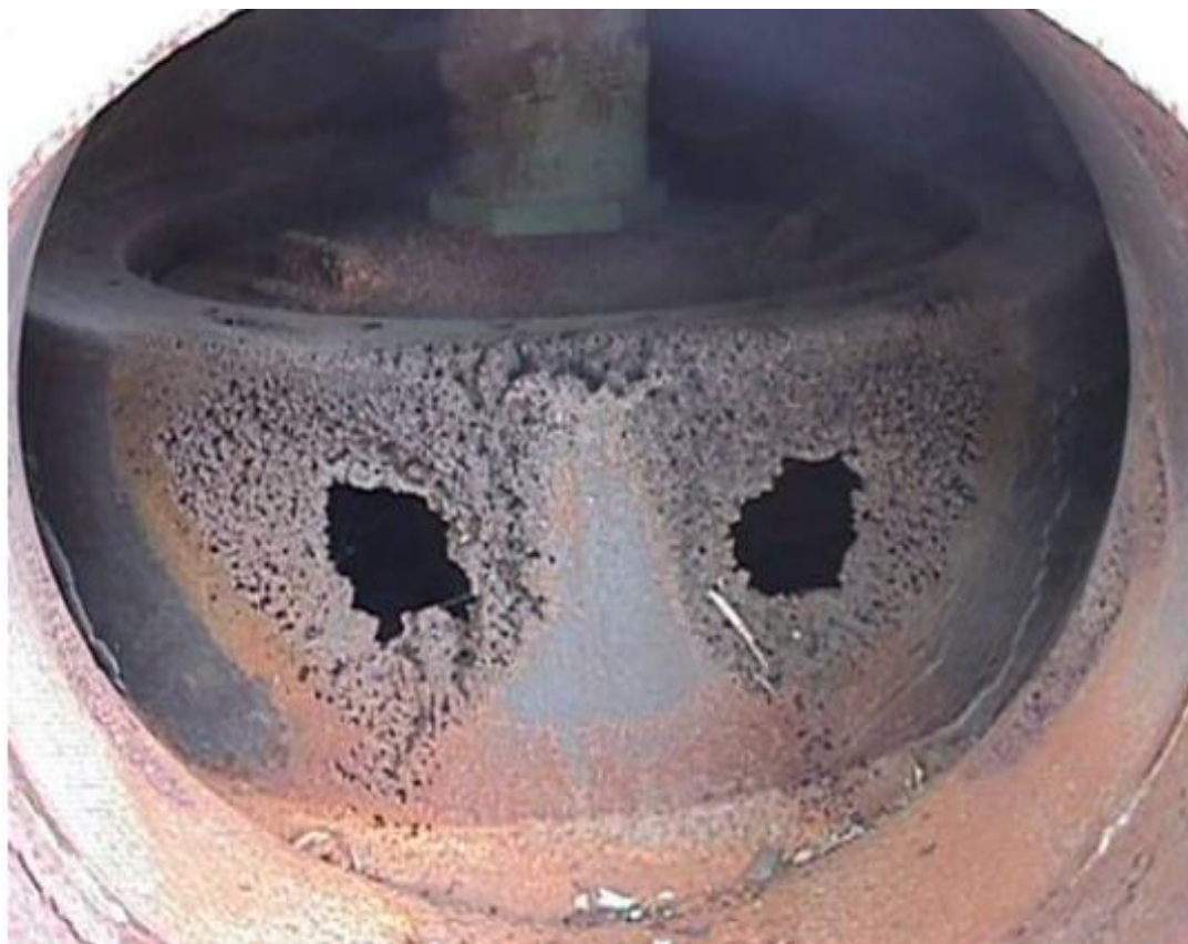
Рисунок 1.8 – Последствия кавитации корпуса двухходового клапана.
