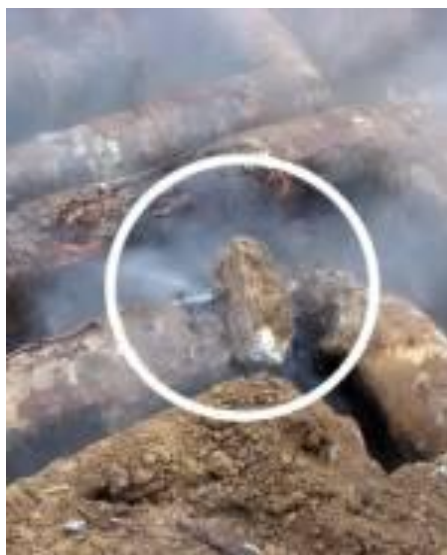
Рисунок 2.11- Место прорыва трубопровода
