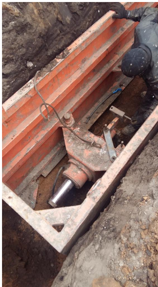
Рисунок 3.2 – Силовое гидравлическое оборудование
