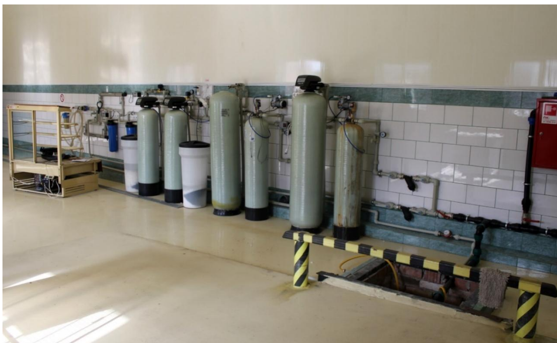
Рисунок 3.5 – Общий вид смонтированной установки
