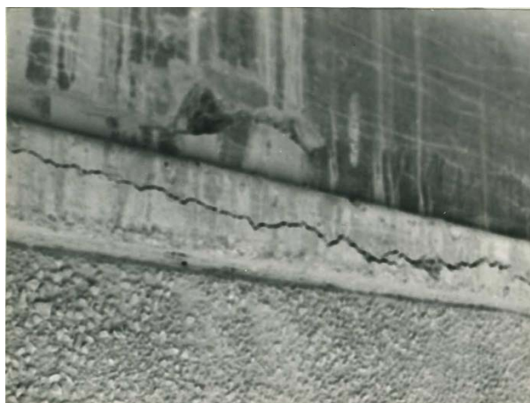
Рис. 2. Разрушенный монолитный бетон жилого дома
