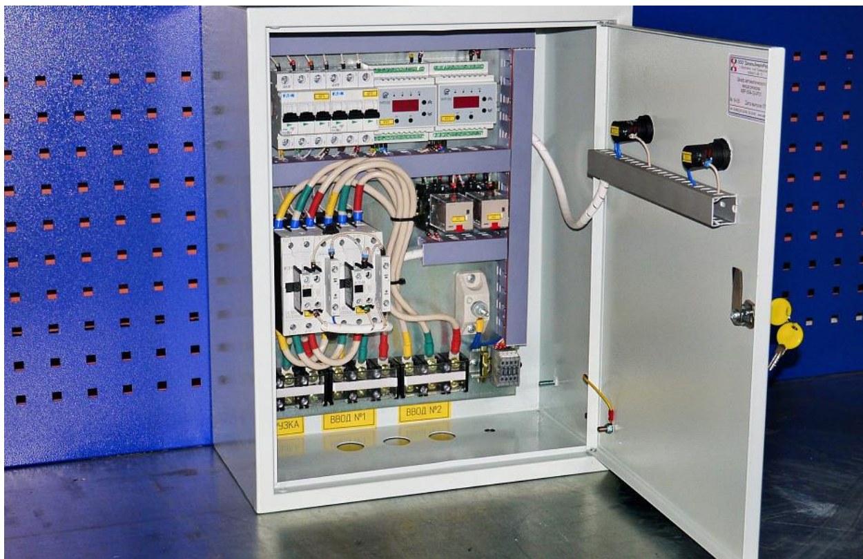
Рисунок 5 - Шкаф АВР-0,4 кВ
