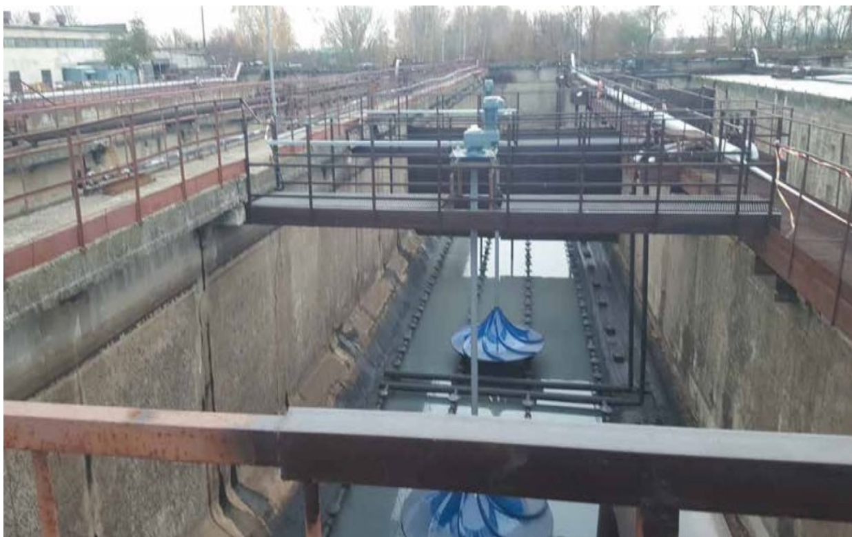
Рисунок 3 – Мешалки серии «Mix GMS» на объекте очистки сточных вод
