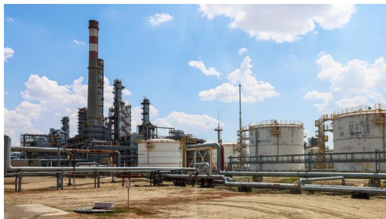
Рисунок 1 – Технологические трубопроводы Атырауского нефтеперерабатывающего завода
