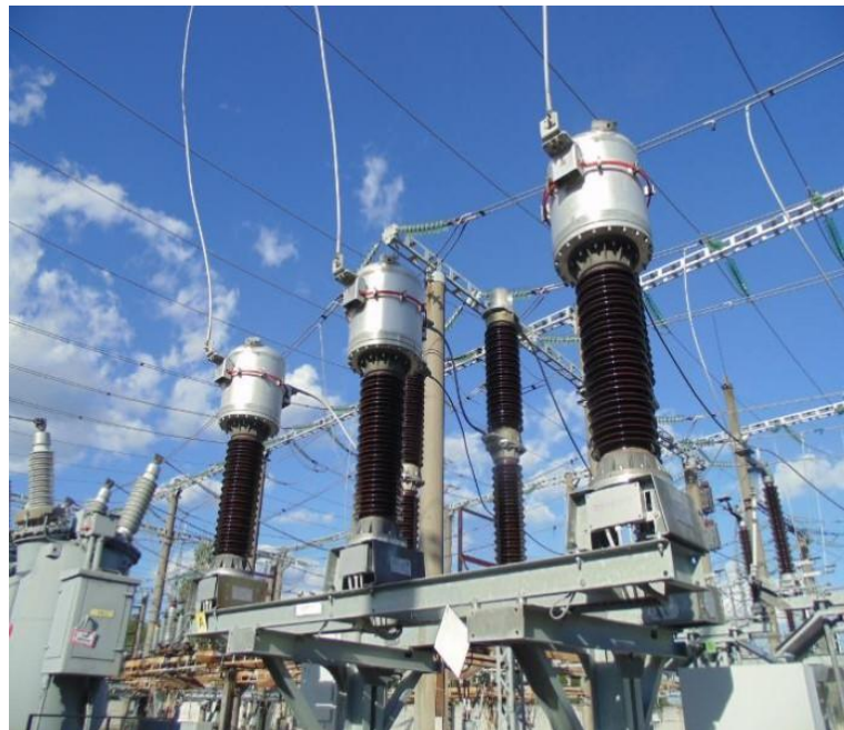
Рисунок 5 – Трансформаторы тока ТОГФ-110
