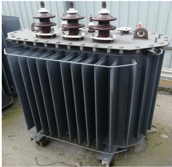
Рисунок 9 – Трансформатор ТМГ33 ХЗК2
