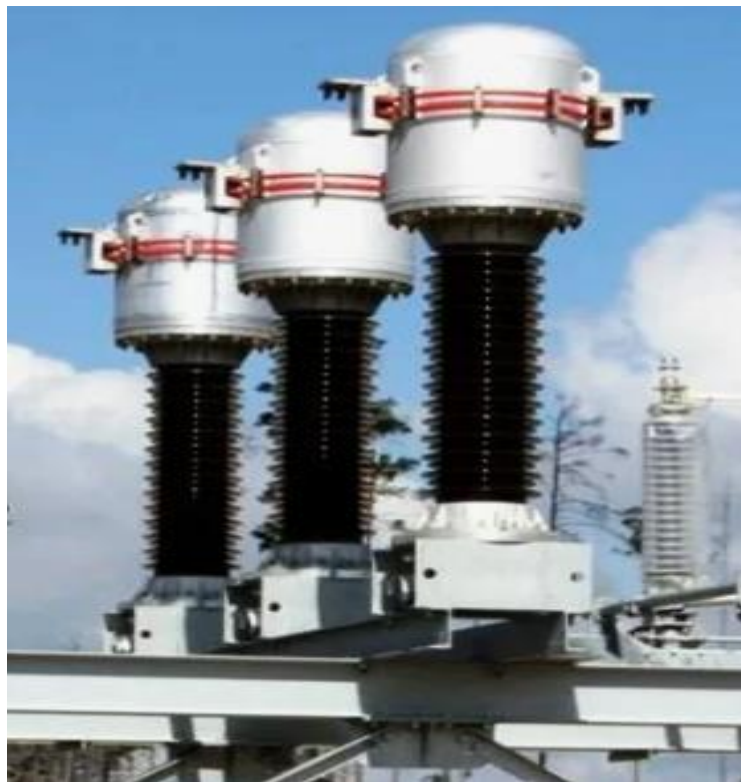
Рисунок 6 – Трансформаторы тока ТОГФ-110
