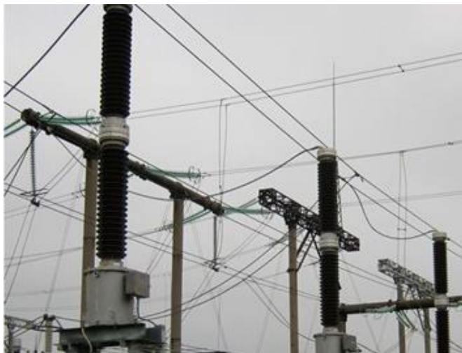
Рисунок 5 – Трансформаторы тока ВЛ-330 кВ на ОРУ-330
