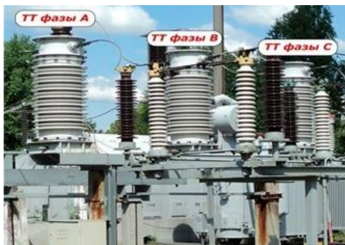
Рисунок 4 – Выносные трансформаторы тока силового автотрансформатора стороны 110 кВ на ОРУ
