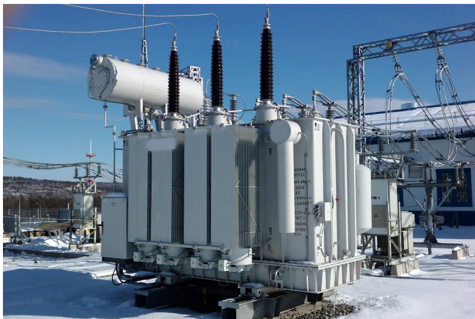
Рисунок 4 – Силовой трансформатор 110 кВ
