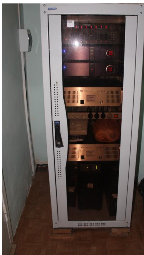
Рисунок 5 – Установлена современная система оповещения и управления эвакуацией при пожаре 3 типа
