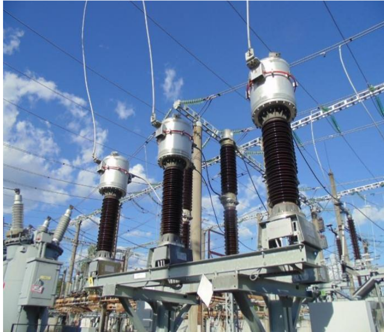
Рисунок 5 – Трансформаторы тока ТОГФ-110
