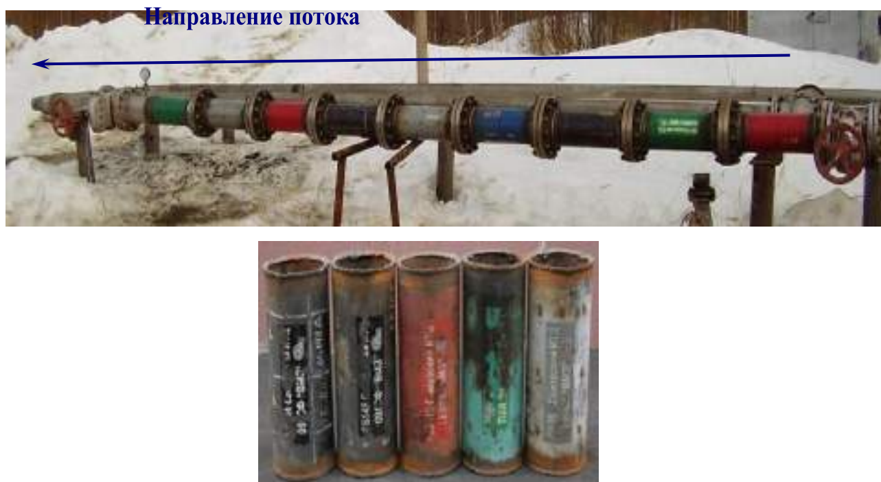
Рис. 2.5 – Байпасная линия испытания труб на нефтесборном коллекторе к.34А Мамонтовское месторождение ООО «РН-Юганскнефтегаз» и катушки, вырезанные из труб
