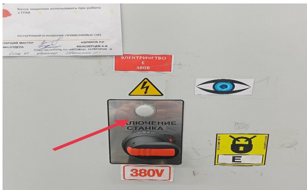
Рисунок 26 - Шкаф управления стандом.
