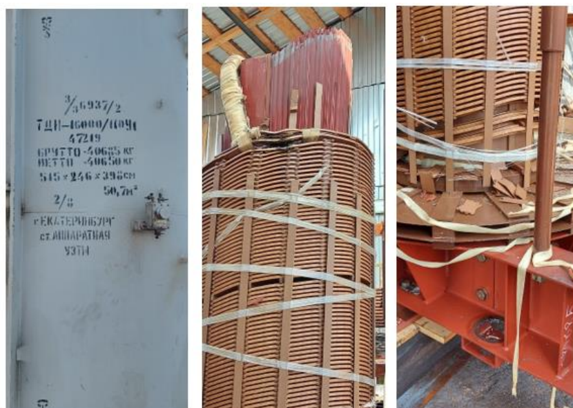
Рисунок 15 – Силовой трансформатор ТДН-16000/100У1
