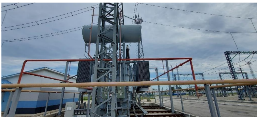
Рисунок 45 – Силовой трансформатор на территории подстанции
