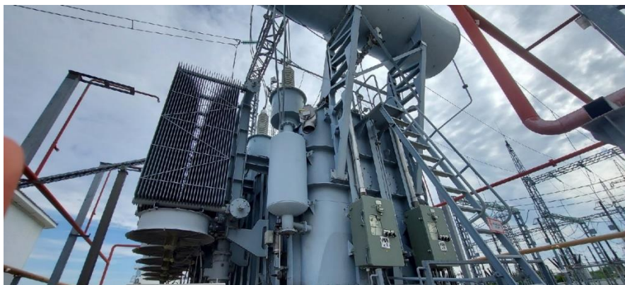
Рисунок 44 – Силовой трансформатор, находящийся на территории подстанции
