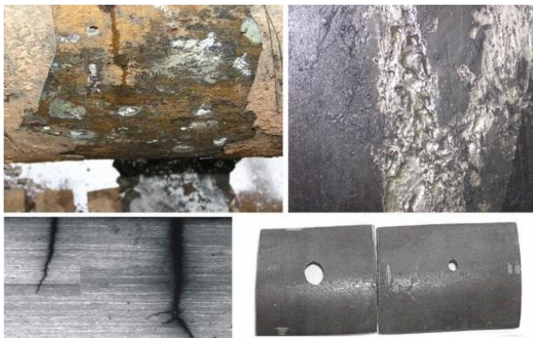
Рисунок 1 - Виды коррозионных повреждений
