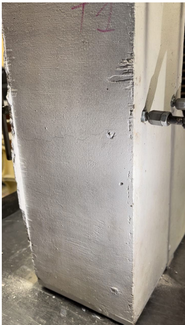
Рисунок 32 – Момент появления трещин в растянутой зоне в КС75
