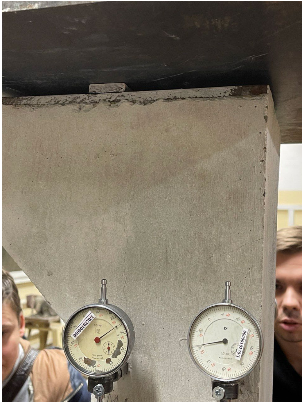
Рисунок 36 – Момент появления трещин в местах расположения пустотообразователей в колонне КП75
