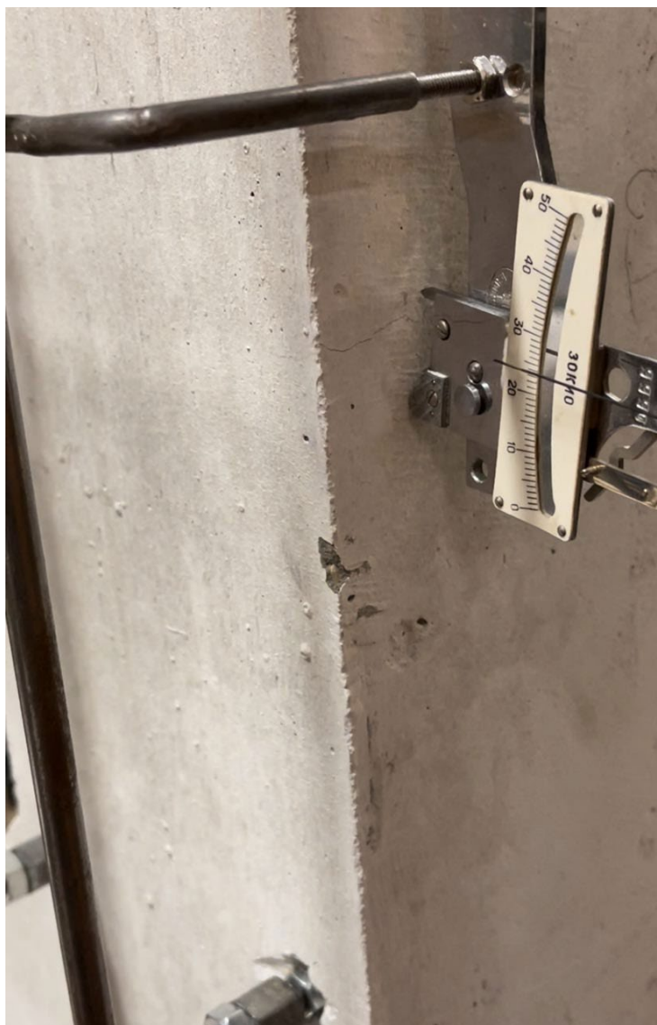
Рисунок 35 – Момент появления трещин в растянуто зоне колонны КП75
