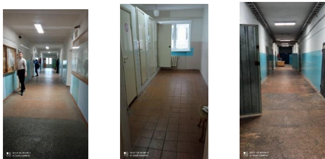
Рисунок 10 – Полы в коридоре и санузлах корпуса «Б»
