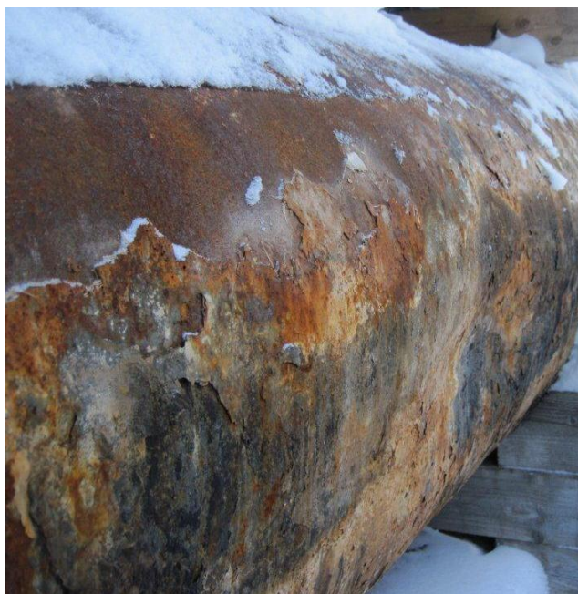
Рисунок 1.7 – Недостаточная коррозионная и жаростойкость жаровой трубы
