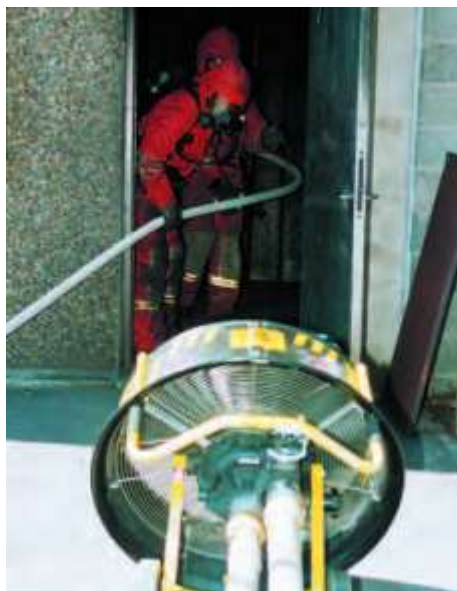
Рисунок 4 – Установка вентилятора на нагнетание воздуха в помещение
