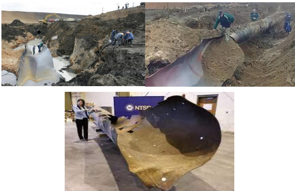
Рисунок 5 - Протяженное разрушение МГП
