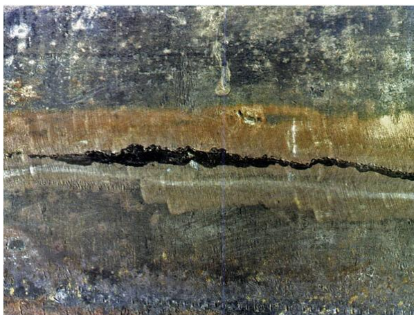
Рисунок 2 – Трещина в теме трубопровода
