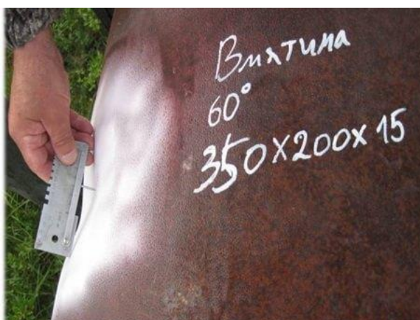
Рисунок 1 – Вмятина на поверхности газопровода
