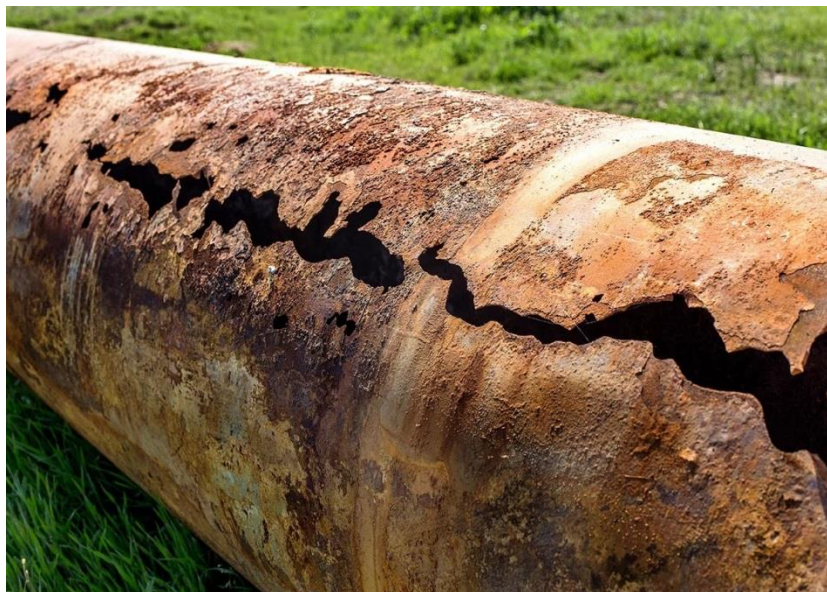
Рисунок 11 – Почвенная коррозия труб
