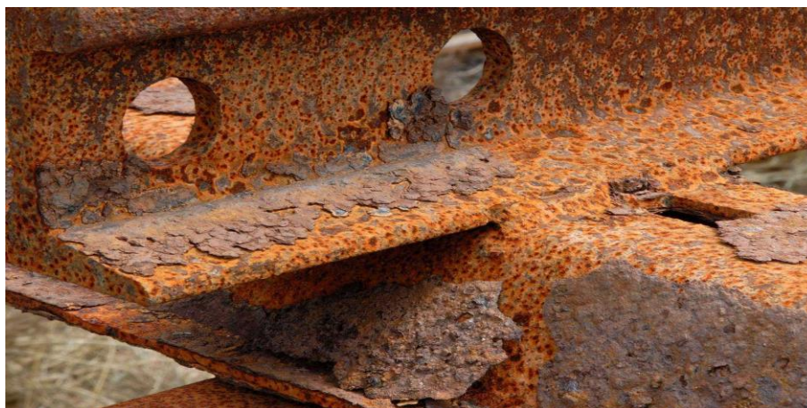
Рисунок 10 – Атмосферная коррозия металла
