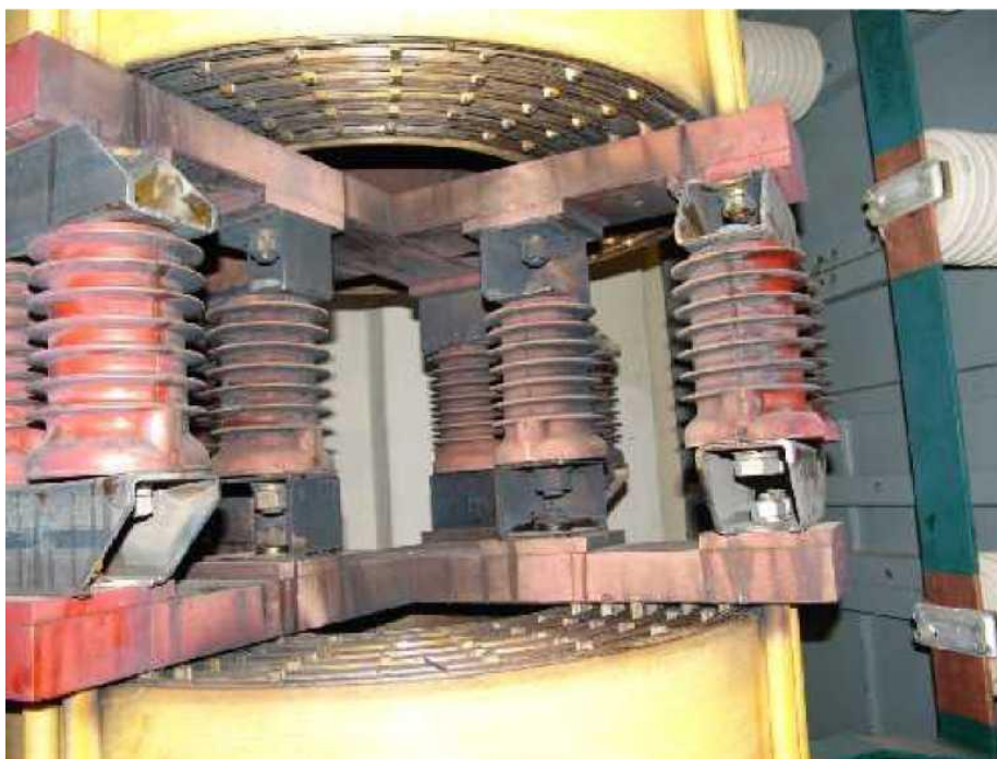
Рисунок 2 – Внешний вид реактора РБ-5ТГ после аварии 21.07.2014
