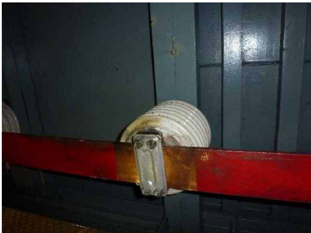
Рисунок 4 – Следы перекрытия по поверхности опорного изолятора (21.07.2014)
