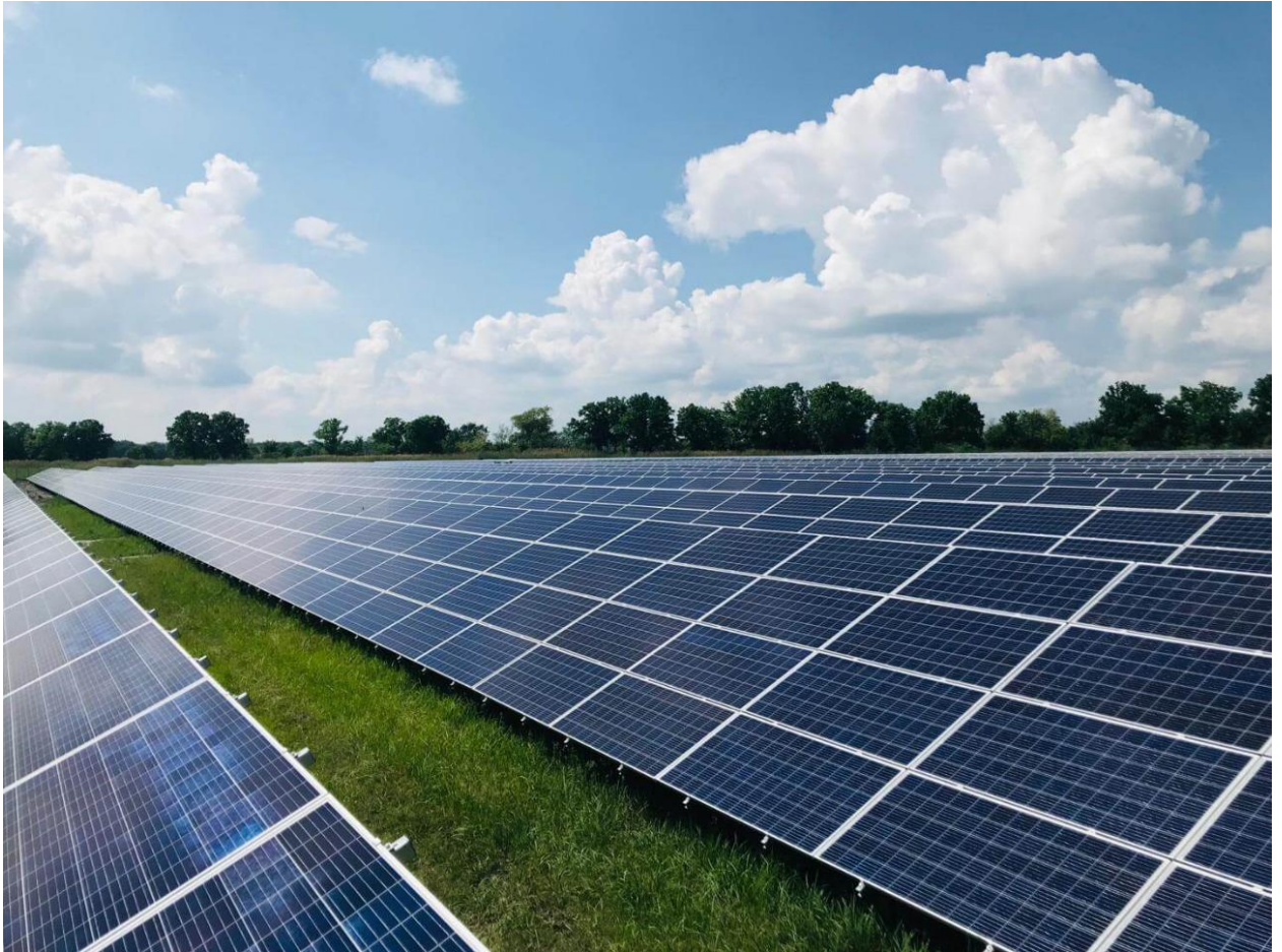
Рисунок 3 – Солнечная электростанция на фотоэлектрических элементах
