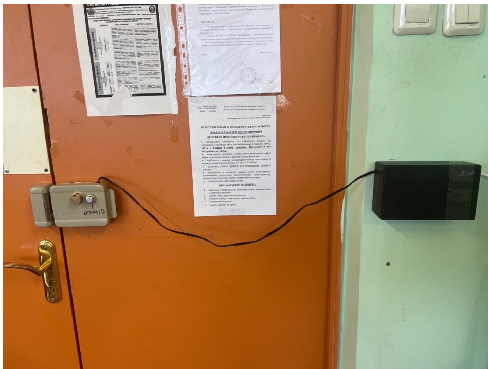
Рисунок 28 – Введенный в эксплуатацию аппаратный комплекс
