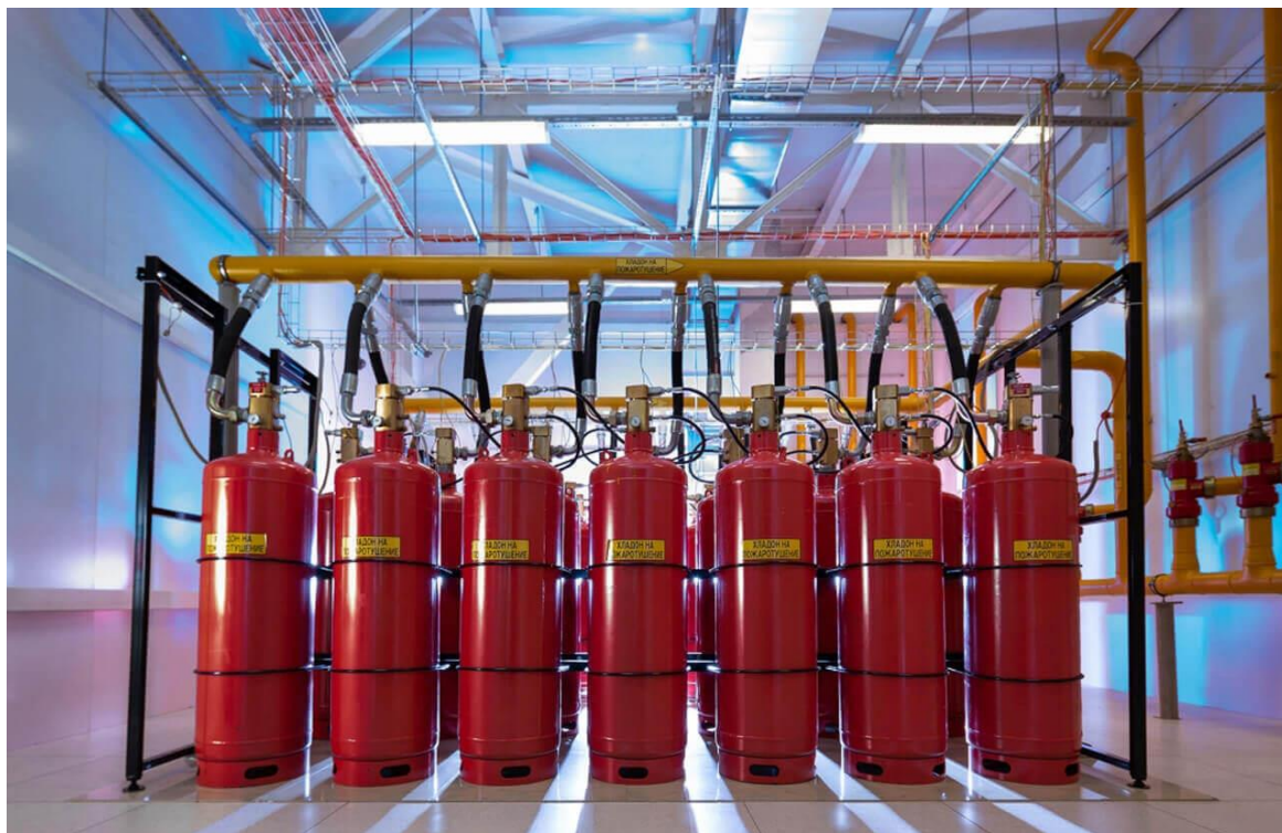
Рисунок 6 – Системы газового пожаротушения в складских помещениях
